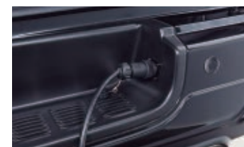
⑨外部電源
